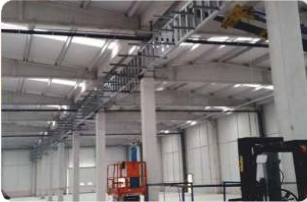
• Tesisat ve Elektrik Konsolu
