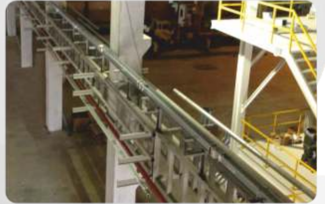
• Tesisat ve Elektrik Konsolu
